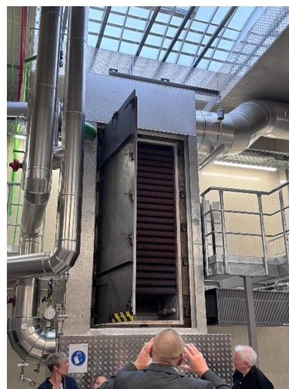
Der geöffnete Abgaswärmetauscher der neugebauten dritten Ofenlinie
